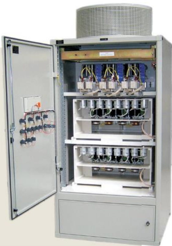
Otevřený rozvaděč měniče s výkonovými součástkovými bloky
