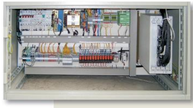
Pomocné obvody měniče s mikroprocesorovým regulátorem EMADYN
