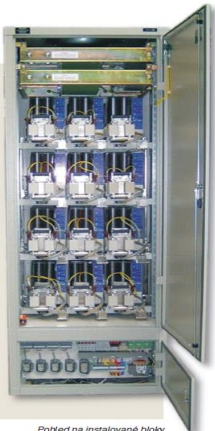
Pohled na instalované bloky v měniči VARIANT
