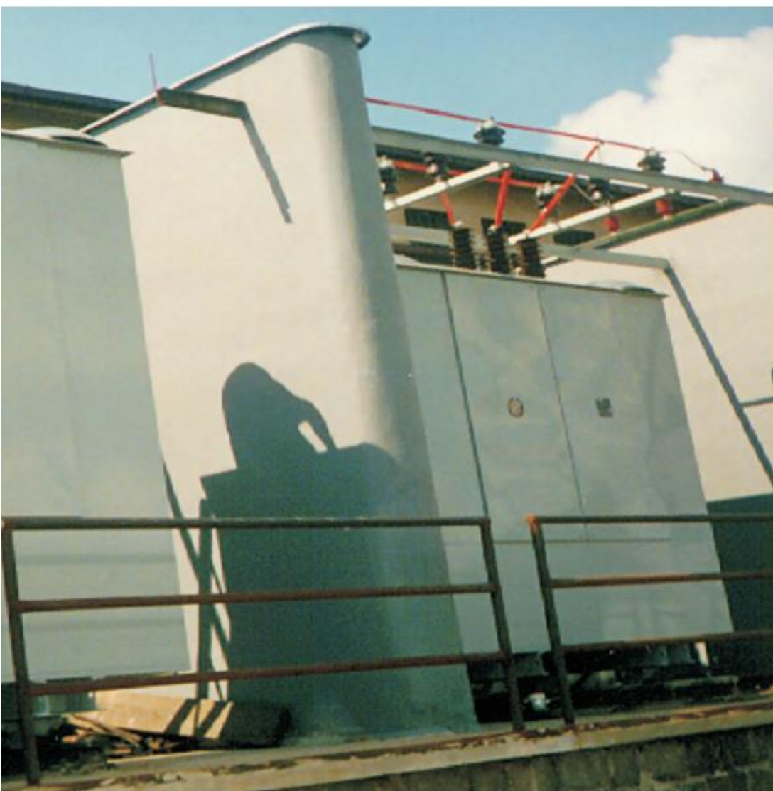
Наружное шкафное исполнение тяговых трансформаторов 38Т-23SF-184/83 5,3МВА на подстанции Опочинек
