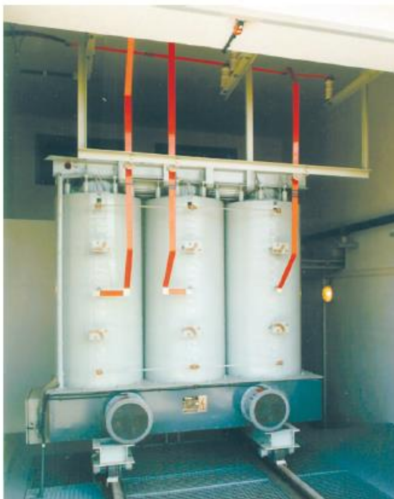
Тяговой трансформатор в исполнении IP00
