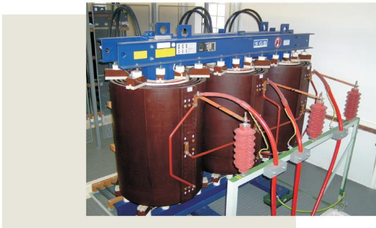
Трансформатор 1100кВА, 22/0.65 Кв
