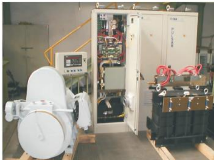
Sestava měničů PULSAR s boosterem, transformátorem a ovládacím panelem
