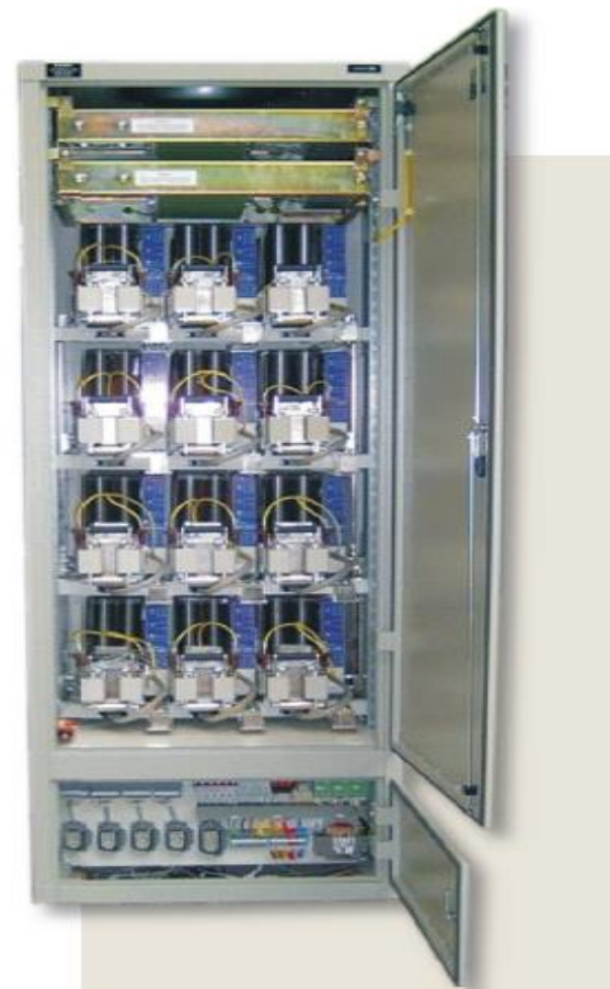
Вид на установленные блоки в преобразователе VARIANT
